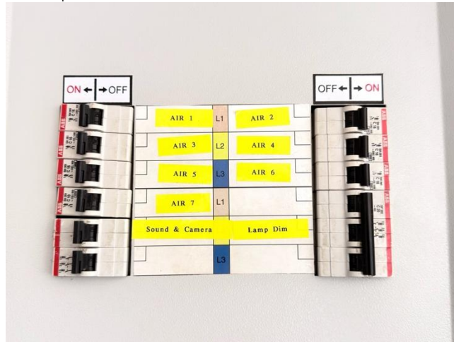
ภาพที่ 49 แสดงการเปิดใช้งานตู้ไฟ ที่มา : (ภาพถ่ายโดยผู้เขียน, 2569)
