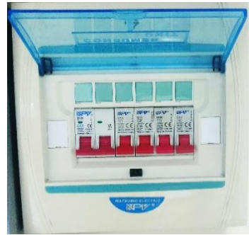
เซอร์กิตเบรกเกอร์ย่อย
